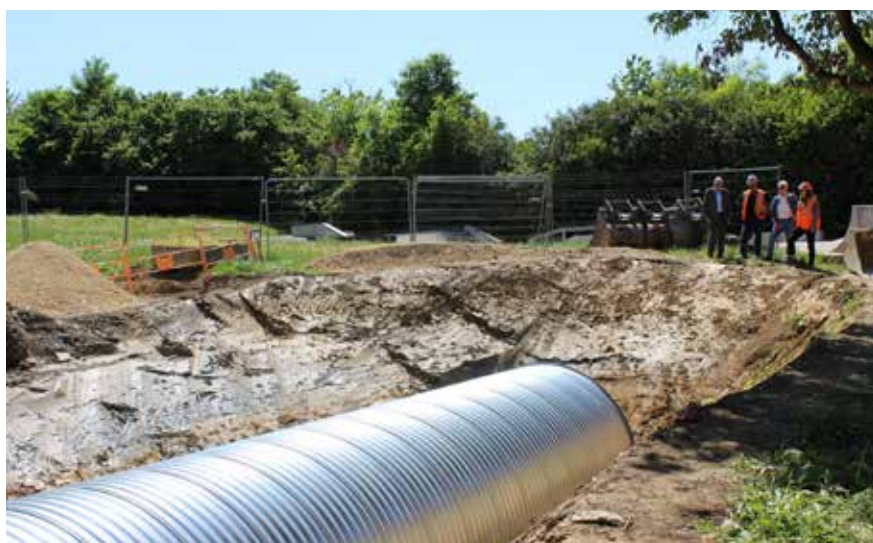
Cette cuve pèse 5 tonnes à vide et 130 tonnes une fois remplie d'eau de pluie.
