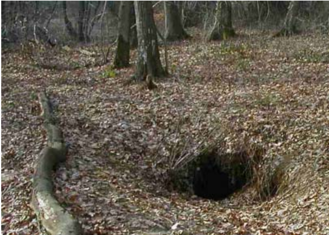
Affaissement sur une ancienne galerie de mines au plateau de Ludres
