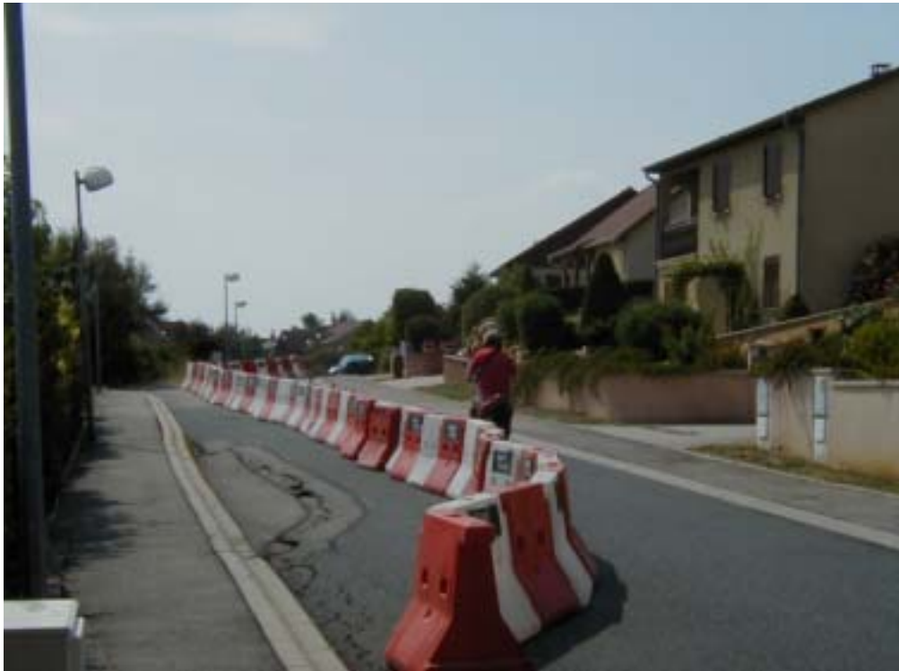
Mouvements de terrains rue Rabelais
